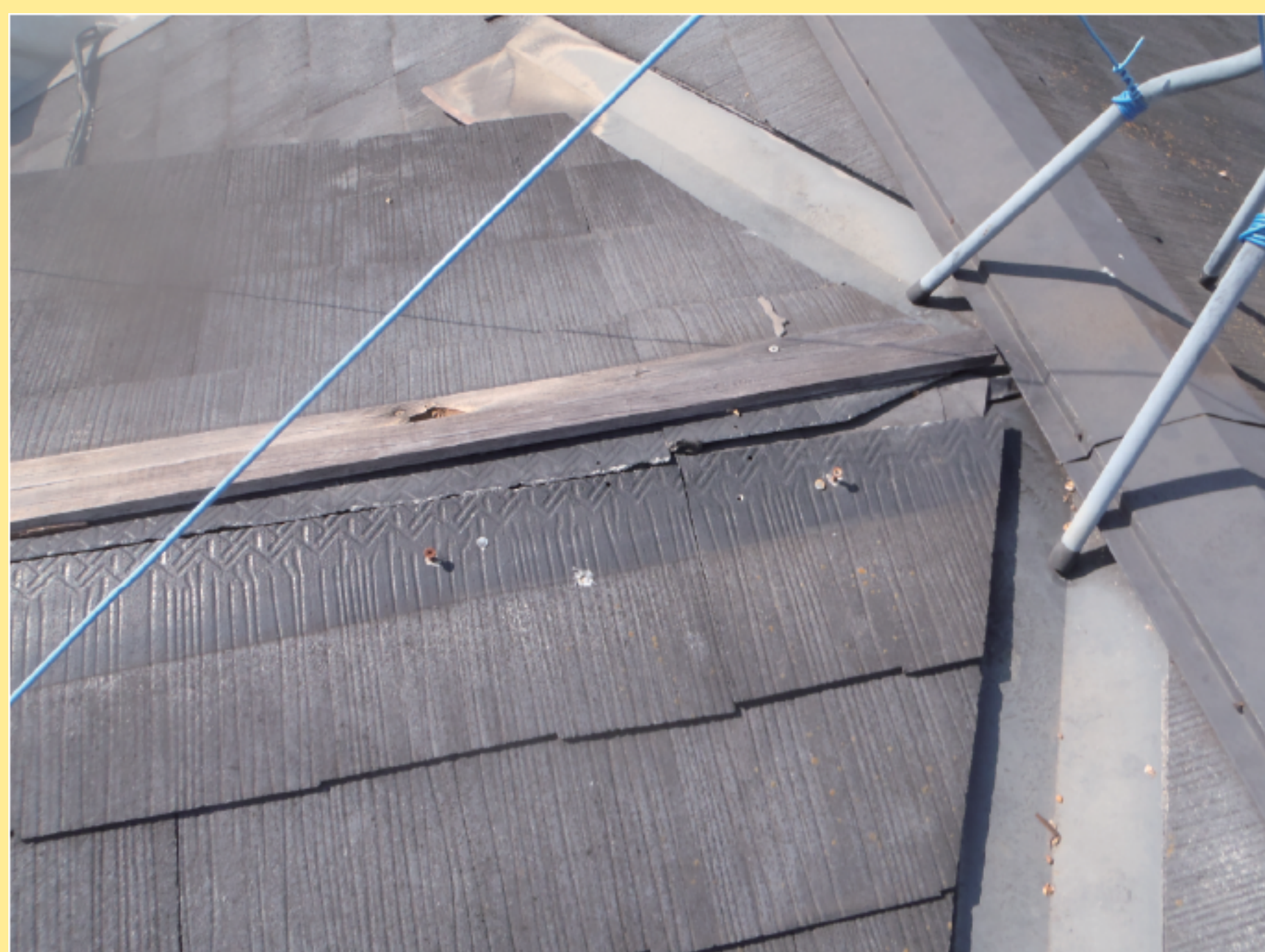
台風時に水切り板金が飛んでしまった
