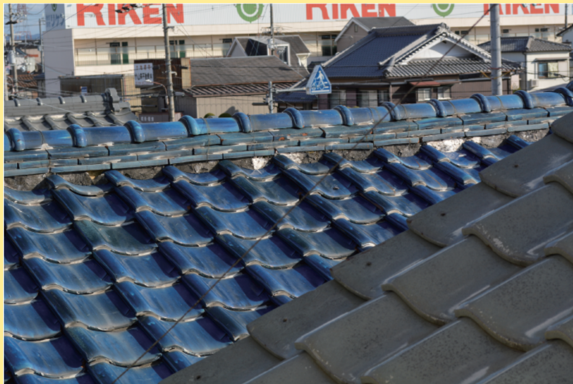
瓦のズレや漆喰部分の破損と劣化による雨水侵入の調査
