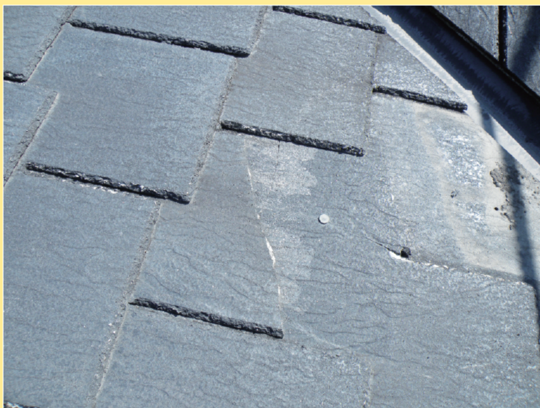
屋根の一部が破損している
