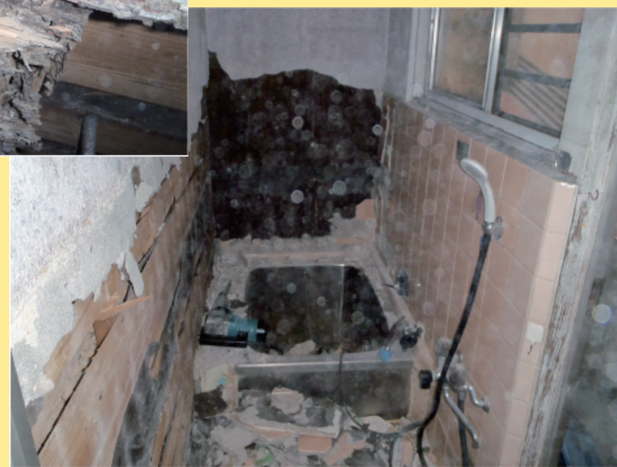
土台や木材の腐れ、湿気による白蟻発生 (床下からも調査します)
