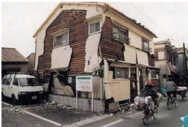
外壁モルタルの剥落
