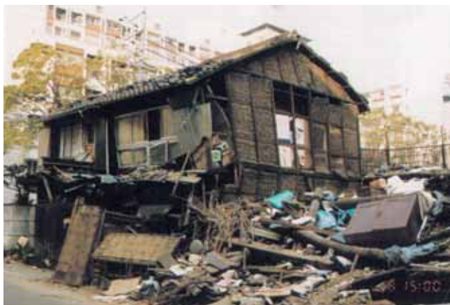
古い構法による被害
