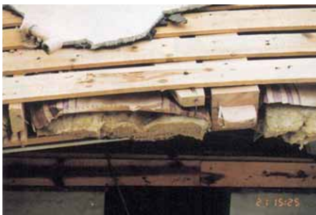
金物補強のない接合部(柱脚—土台)の拔出し
