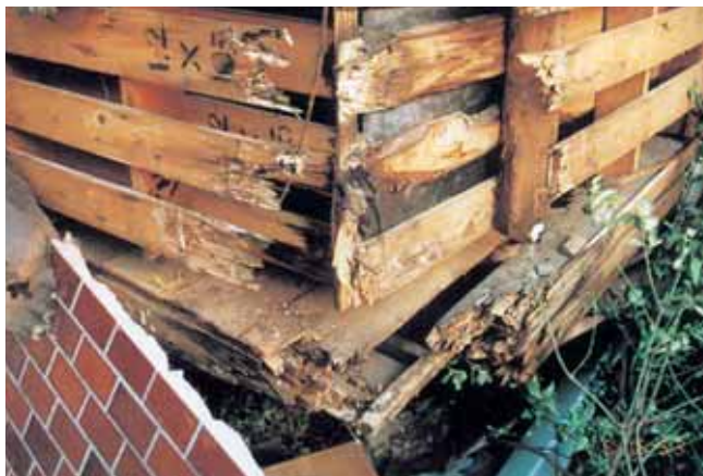
軸組の腐朽・蟻害
