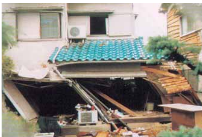
壁量不足で大傾斜した住宅
