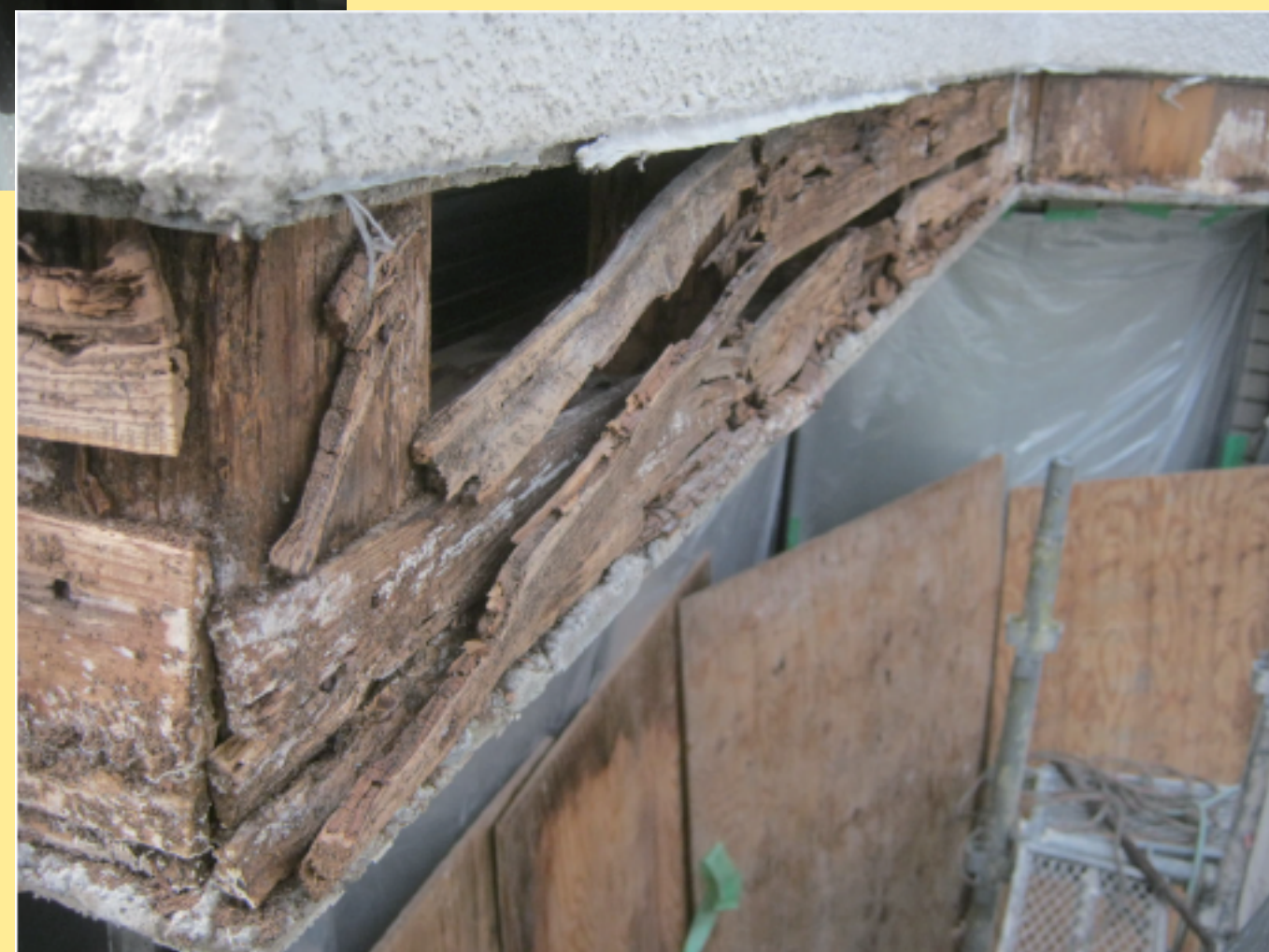
雨水侵入の恐れがありそうな部分の調査 結果、腐っていた事例
