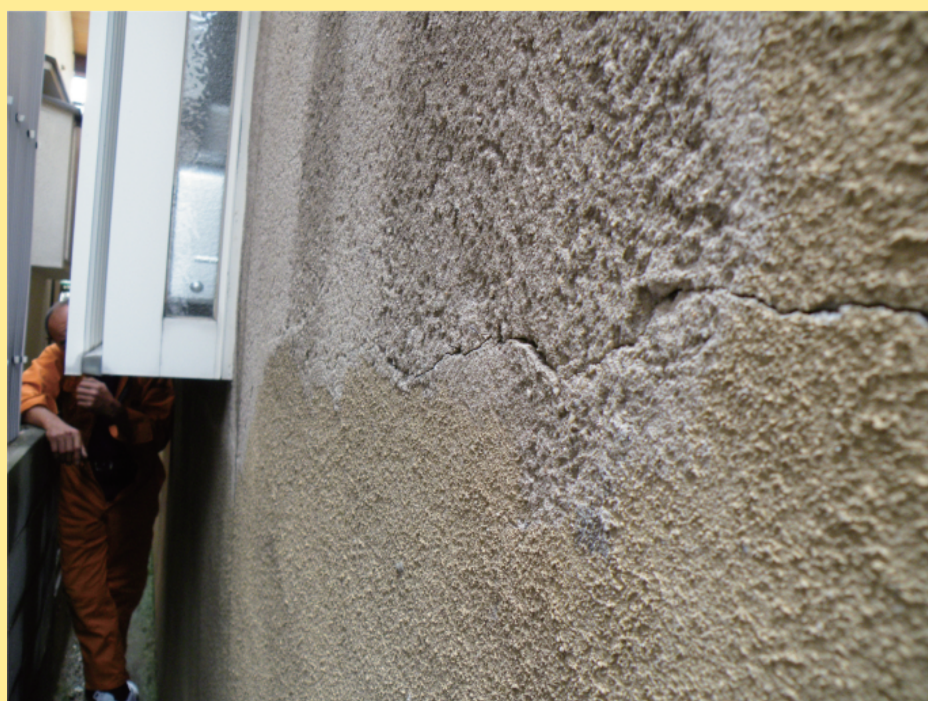
大きく割れた外壁
